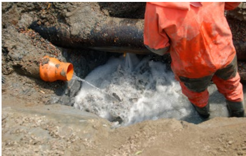
Vannlekkasje. Foto: Rene A. Dupont, GVD
