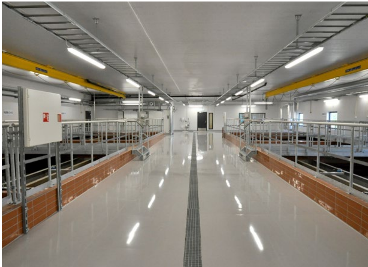
Hurdalssjøen vannbehandlingsanlegg. Foto: Ullensaker kommune
